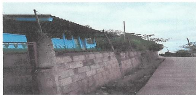
Foto 5: malla en mal estado, sostenida por palos podridos.
