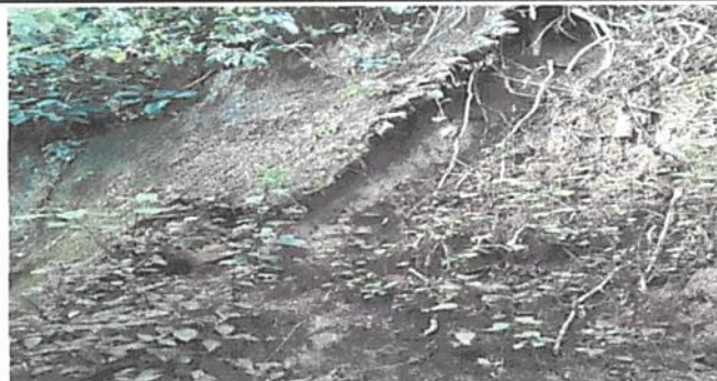
FOTO 2: Desprendimiento de tierra
