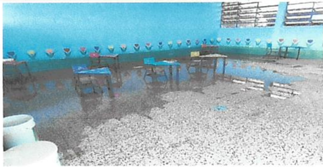
Foto1: Ingresa el agua al salón de clase, por lo dañado del techo.
