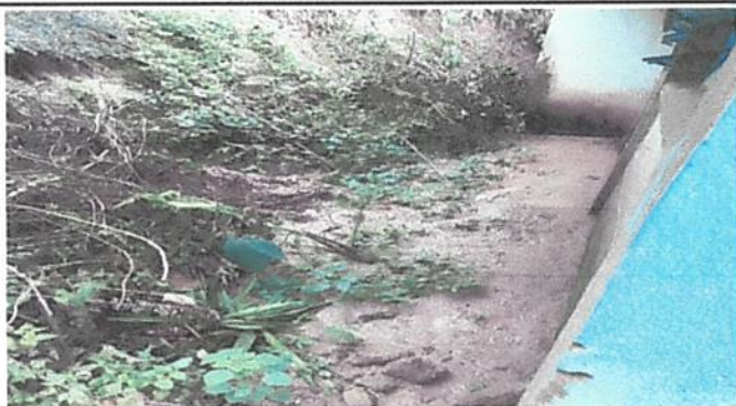
FOTO 1: Deslave a causas de lluvias
