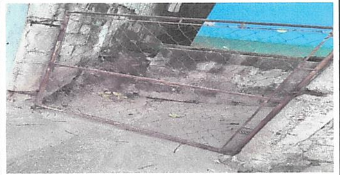
Foto 4: Puerta principal dañada.
