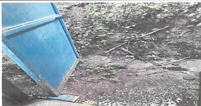
FOTO 3: Saturación de lodo en la puerta
